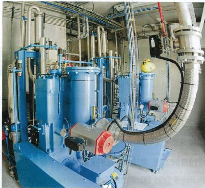
Die Einspeisestation der Powerfarm-Bioerdgasanlage, Tuningen, ins Verteilnetz der Stadtwerke Villingen-Schwenningen. Hierhin gelangen ca. 22 Mio. kWh/a. EGT in Triberg vermarktet die gesamte Produktion.
